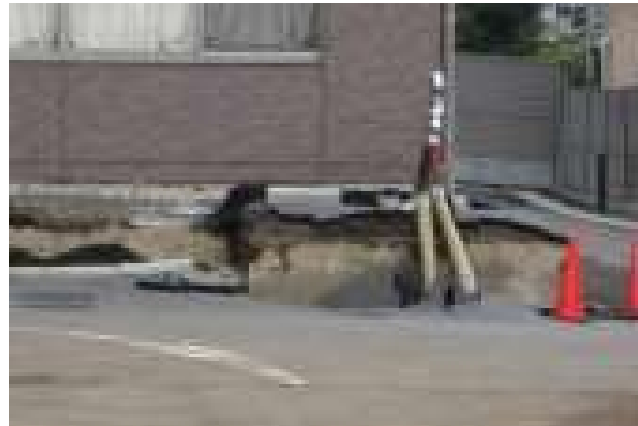
基礎杭の抜け上がり
