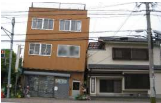
建物の沈下・傾斜
