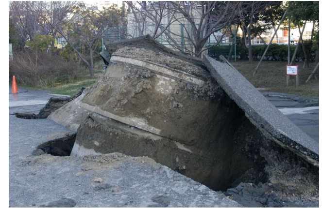
マンホールの浮き上がり
